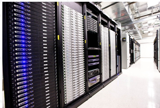
Figura 1.5: Um centro de dados contém vários milhares de servidores interligados por uma rede especialmente dedicada a esse fim
